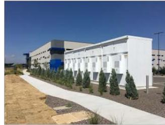
1MW / 2MWh Li-ion
